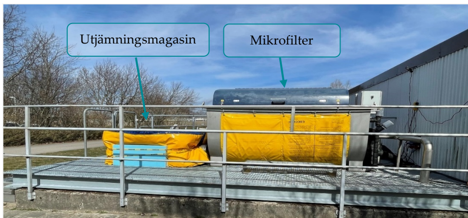
Figur 6. Mikrofilteranläggningen och efterföljande utjämningsmagasin.
